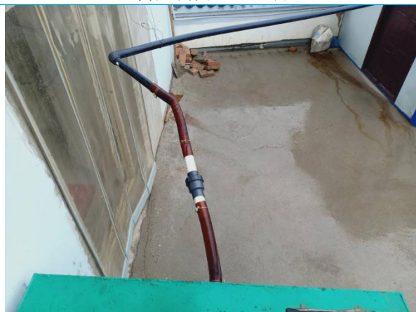
污水泵吸入管线
