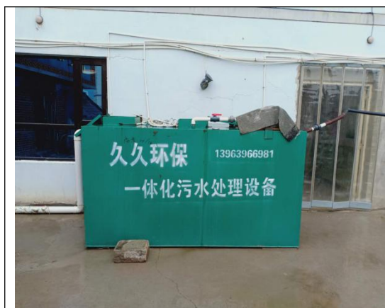
一体化污水处理设备
