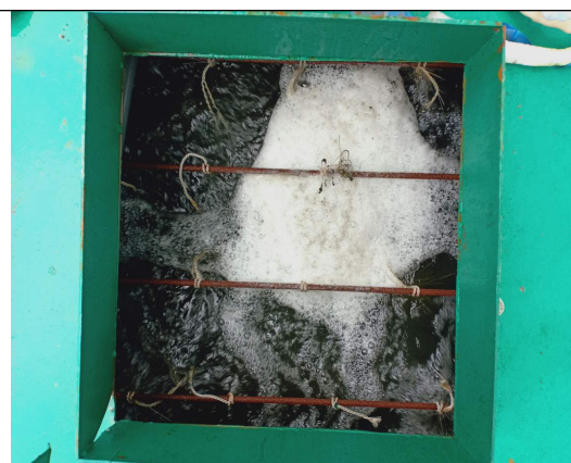
一体化污水处理设备
