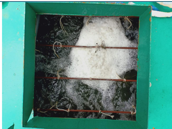
一体化污水处理设备
